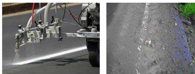
Figura Nº: 3 – COLOCACIÓN Y DESGASTE DE LA SEÑALIZACIÓN HORIZONTAL
