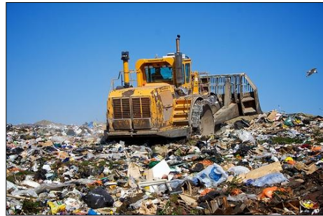
Figura N° 5: Relleno Sanitario en funcionamiento
