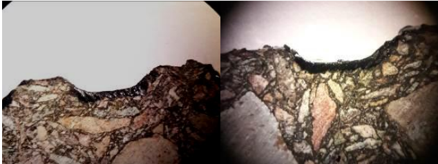
Figura 1. Deposición excesiva de un riego en los valles del fresado.
