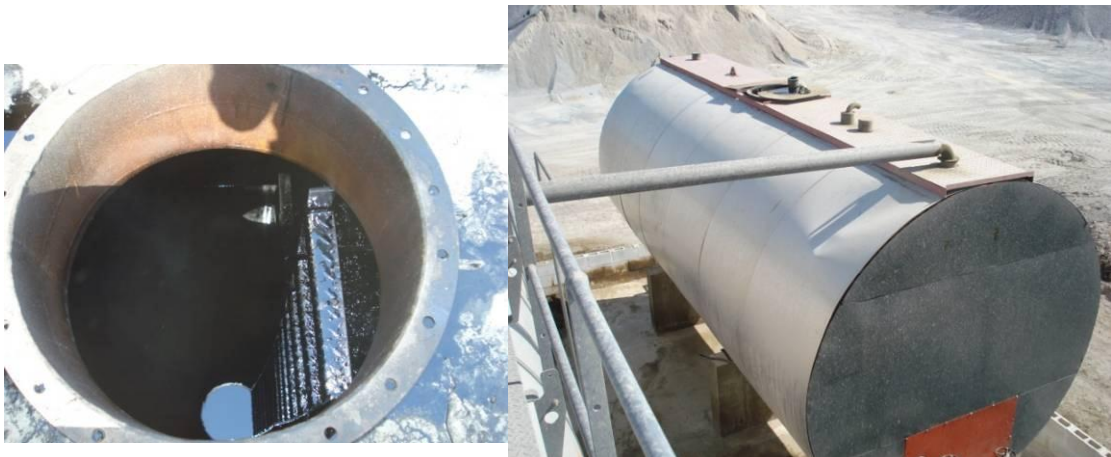
Foto 3: Almacenamiento en la cisterna
