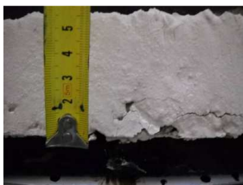
Figura 5: 2º parada minuto 20', h fisura = 17mm
