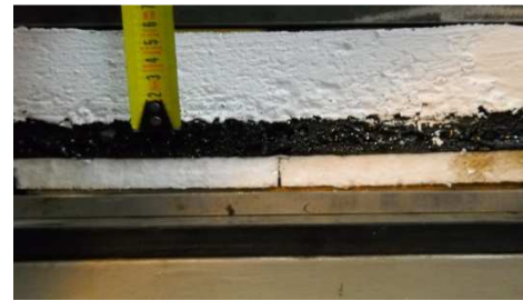
Figura 10: 1º parada minuto 5', h fisura = 21mm
