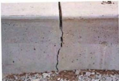
Figura 1. El corte ocasiona la aparición de la fisura en la junta
