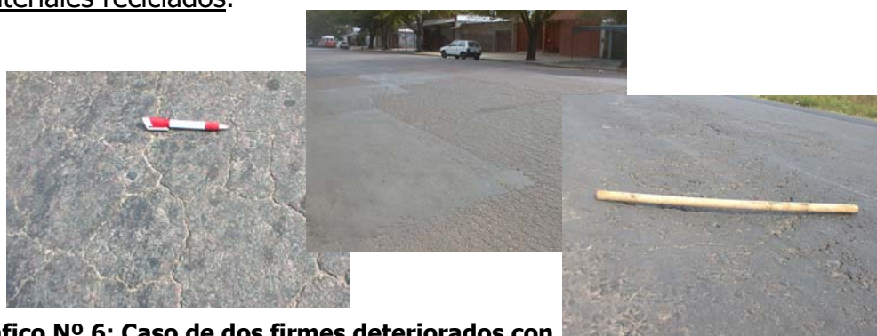
Gráfico N° 6: Caso de dos firmes deteriorados con diagnóstico de reciclado en vías provinciales
