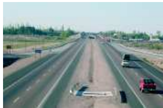
Proyecto de doble vía de acceso Sur a Mendoza (Ruiz y Asoc.)
