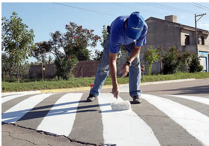
Foto 5: Señalización horizontal en Lomo de Burro
